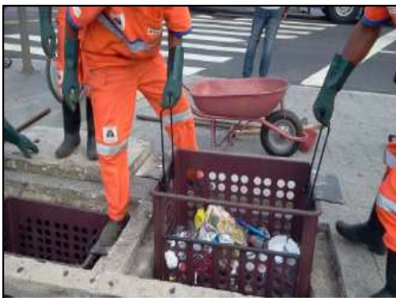
Figura 5. Cesta acoplada à boca do bueiro
