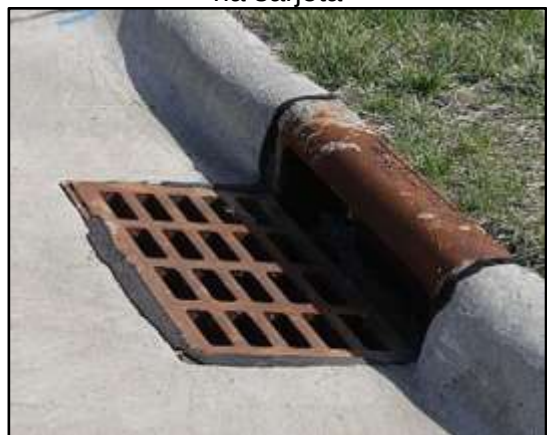
Figura 6. Boca de lobo com gradeamento na sarjeta
